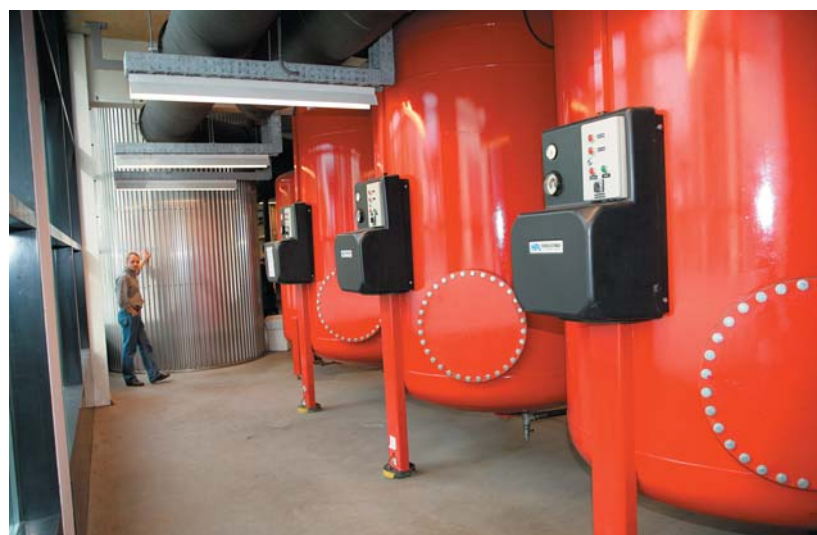
Expansievaten in een warmtekrachtcentrale van Nuon
